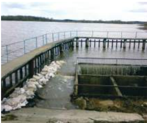
Текущее состояние гидроузла на р.Толмань у д.Малая Шимшурга Новоторъяльского района Республики Марий Эл
