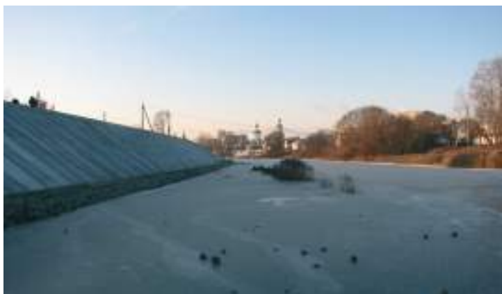
Строительство защитных сооружений г. Йошкар-Ола на участке от ул. Водопроводной до ул. Красноармейской
